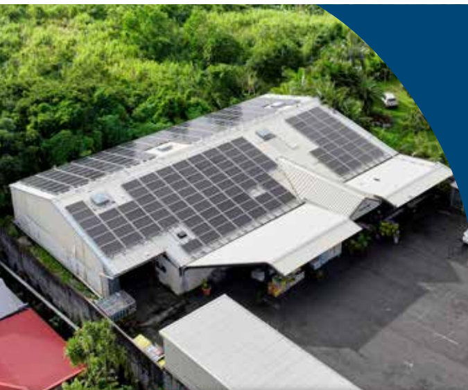
Installation en toiture de bâtiments industriels et tertiaires
